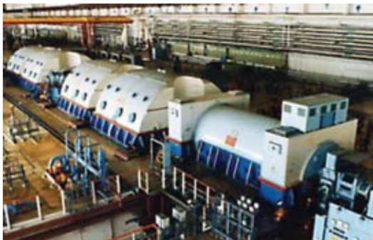
Турбинный зал РБМК-1000
